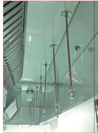
フード消火設備
