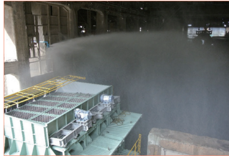
開放型スプリンクラー設備
