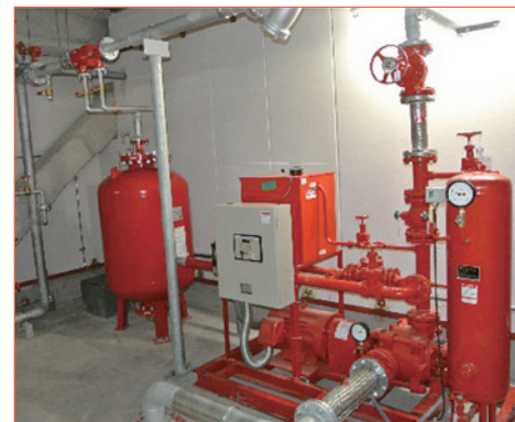
泡消火ポンプユニット
