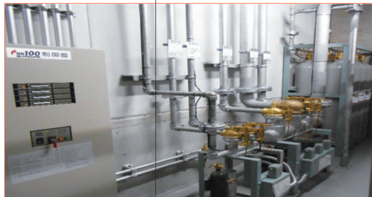
ガス消火設備
