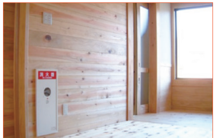
消火器ボックス
